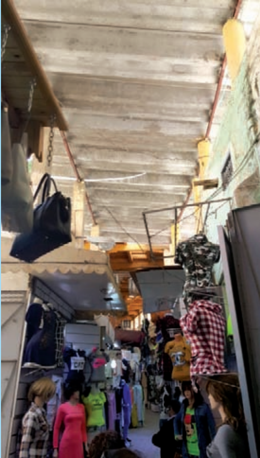
Souk Attarine à Meknès. État avant ...
