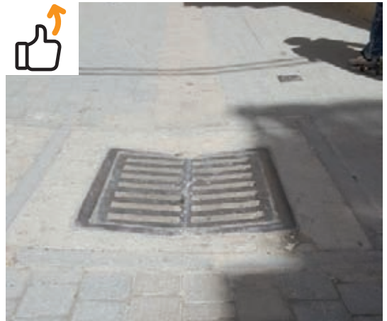
Le raccord entre les modules du pavage et l'affleurement est assuré par un élément intermédiaire en béton.
