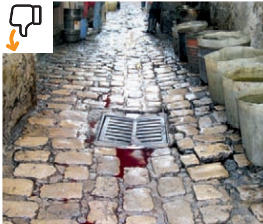
L'absence d'un élément de raccord compromet la qualité visuelle de l'aménagement de surface
