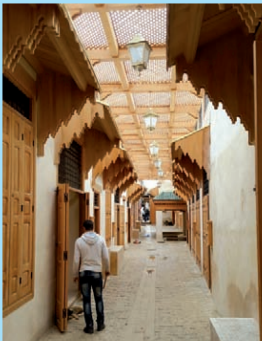
... et après intervention
