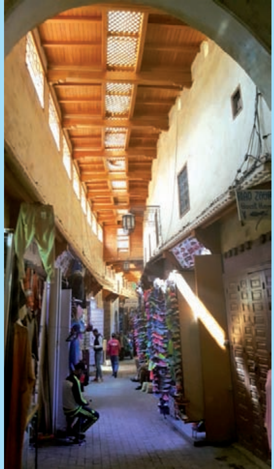
... et après intervention
