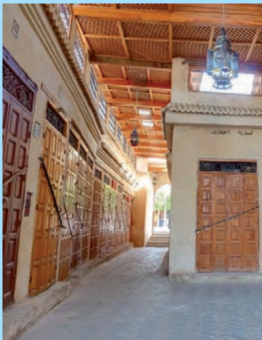
... et après intervention
